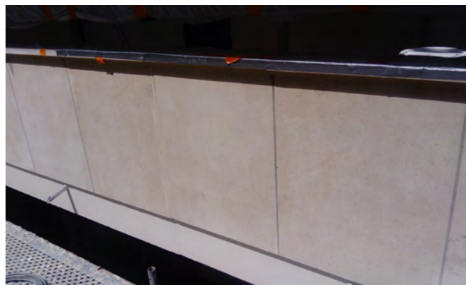
Suite au traitement OXIPHYCÉE effectué après nettoyage (pollution végétale éliminée)
